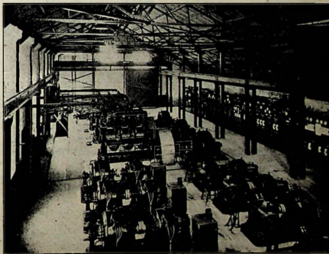
De machinehal met schakelborden en verlichtingsinstallatie, waar ook de energie voor de zendlampen wordt opgewekt.
